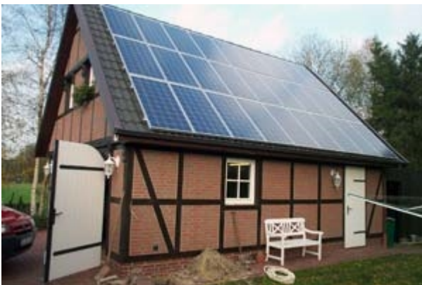
4,7 KW auf einem Nebengebäude
